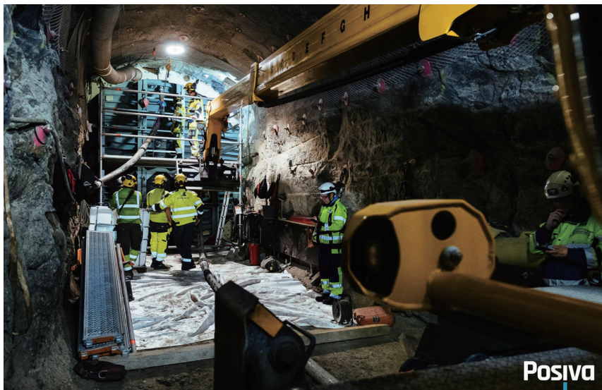
整合系統測試的隧道。(圖片來源: Posiva)
