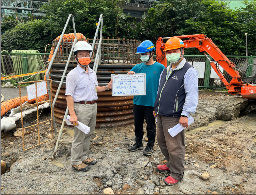
69kV GIS 施工停留點品質查驗 (圖左) · 23kV GIS 基礎坑 (圖右)。
